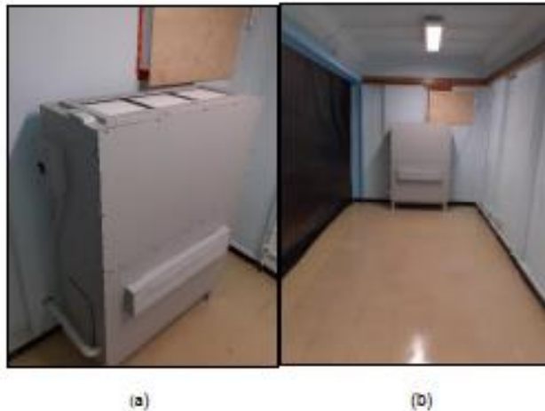
Fig.2 – Protótipo Construído e Instalado. (a) Configuração final. (b) Instalação na sala de testes.
